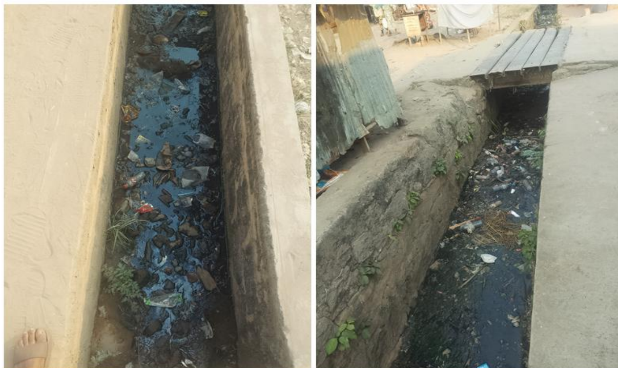
Photo N° 2: les eaux usées dans le caniveau à kelekele
